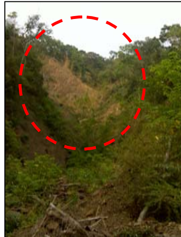
支流3(內英橋)崩-9
