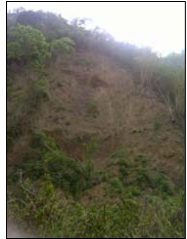
支流3(內英橋)崩-13
