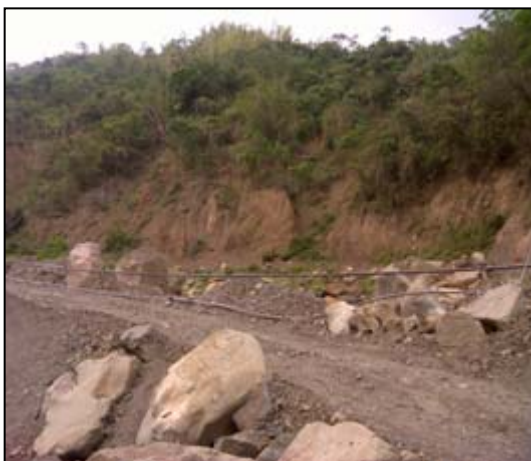
支流3(內英橋)崩-15
