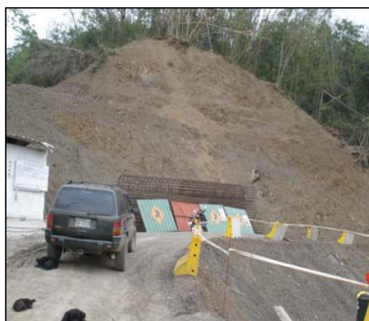
支流1(上智橋)崩-18
