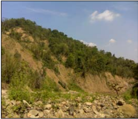
支流4(珍藍橋)崩-3
