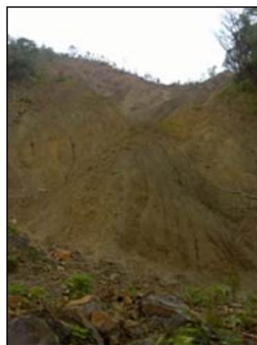
支流1(上智橋)崩-14
