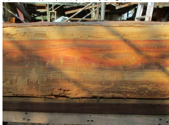
圖 72. 台灣杉大徑木之邊材多已腐朽不堪使用
