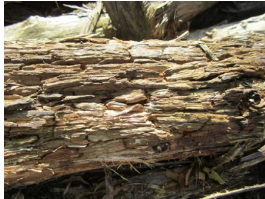
圖 34. 木材表面因多雨且曝曬而腐爛脆化
