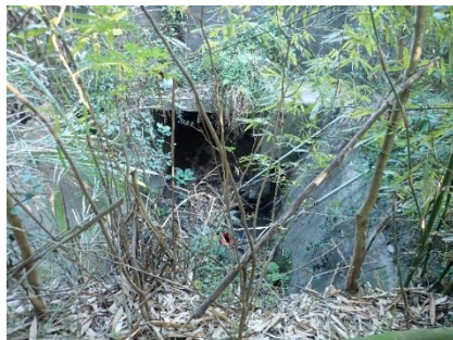
(17)27.7K 箱涵 7 東向南側出入口有陡深大集水井，動物一旦誤入，將難以脫逃；西向北側出入口離地面溝渠落差大，現況無法利用為動物通道。
