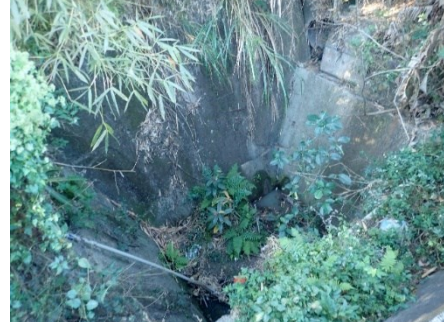
(18)27.7K 箱涵 7 東向南側入口的陡深大集水井，建議增設之字形逃生坡道，或於周邊加設圍籬網避免動物掉入無法逃出。並於西向北側出口增加之字型爬坡道進行改善。
