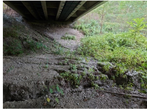
(10) 馬頭山一號橋橋下通道形成 2 道沖蝕溝，南區養護工程分局已規劃進行 U 型砌石溝整治及設置動物飲水池，增加動物利用
