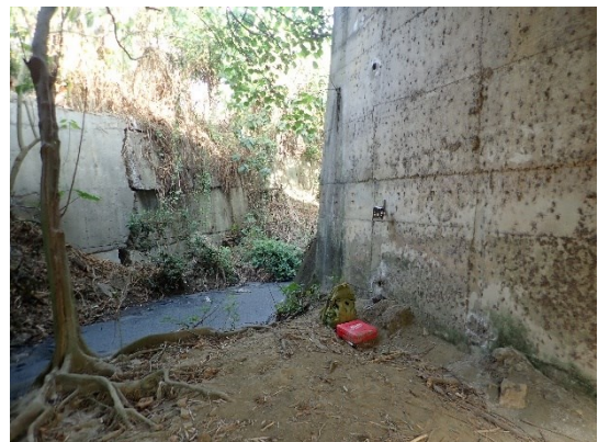
(12) 鹿天橋溪水受到養豬場廢水排放影響，水質黑濁，且北側護岸陡峭，需進一步改善
