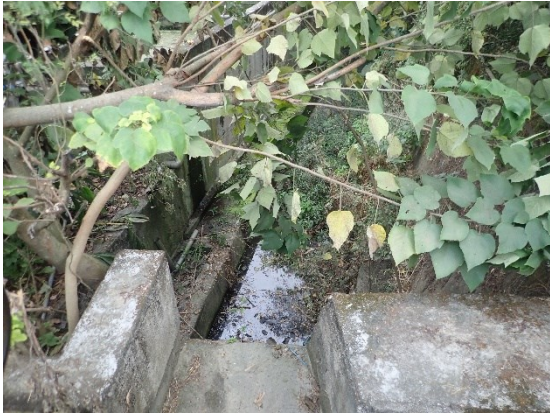
(3) 22.9K 附近的無名橋為三面光溝渠，西向北側護坡有兩階，建議於第二階加上逃生坡道，可做為食肉目通道。
