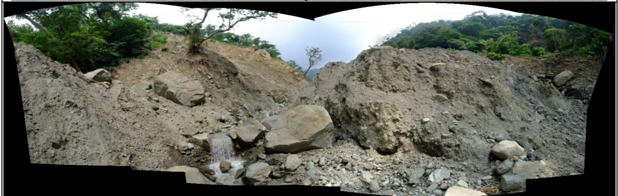
里程 1K+000 崩塌堆積現況 (98.10.21)
