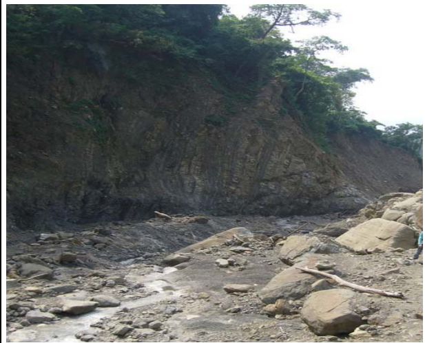
里程 0K+915 右岸崩塌堆積現況 (98.10.21)
