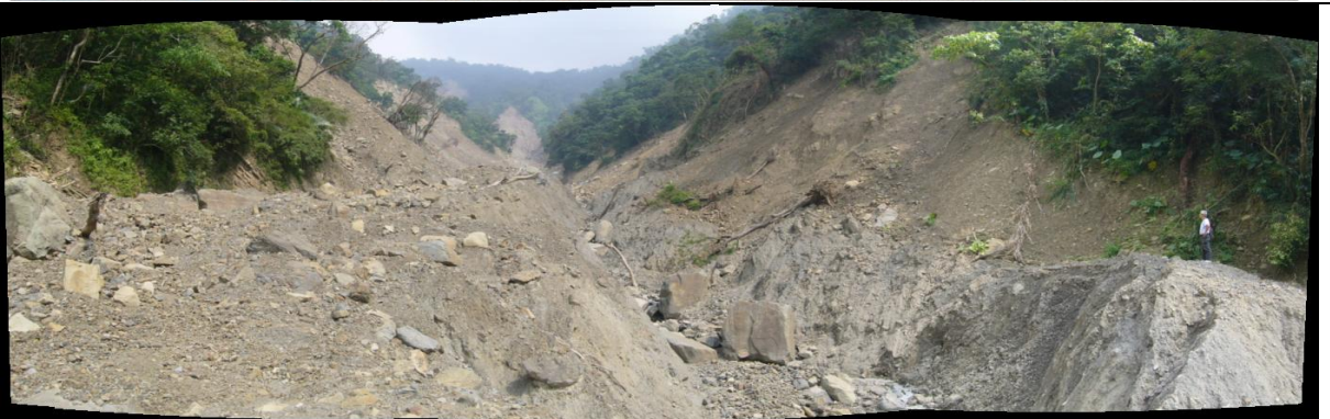
里程 1K+200 崩塌現況 (98.10.21)
