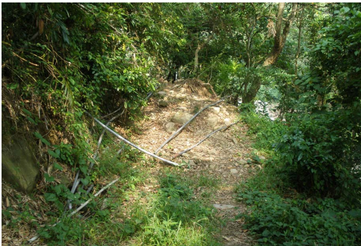
圖 3-3 火山坑集水區道路損壞情形照片圖
